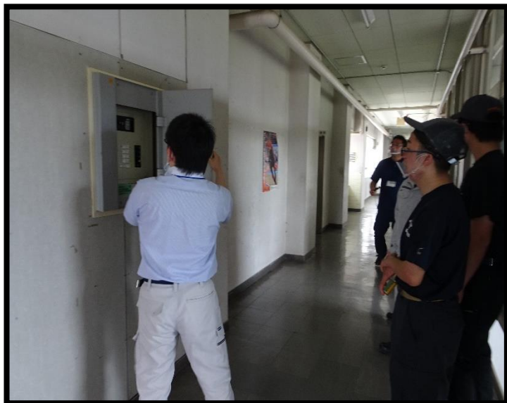
【ブレーカー切断中】
